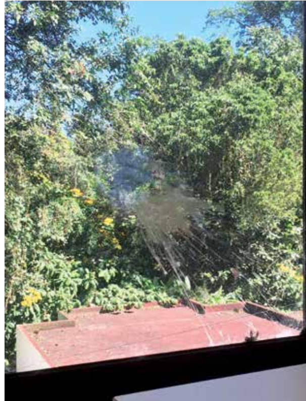
Figura 2. Marca característica que se puede encontrar en las ventanas de edificaciones urbanas en las que ha ocurrido la colisión de un ave. Foto: Erick J. Corro.
