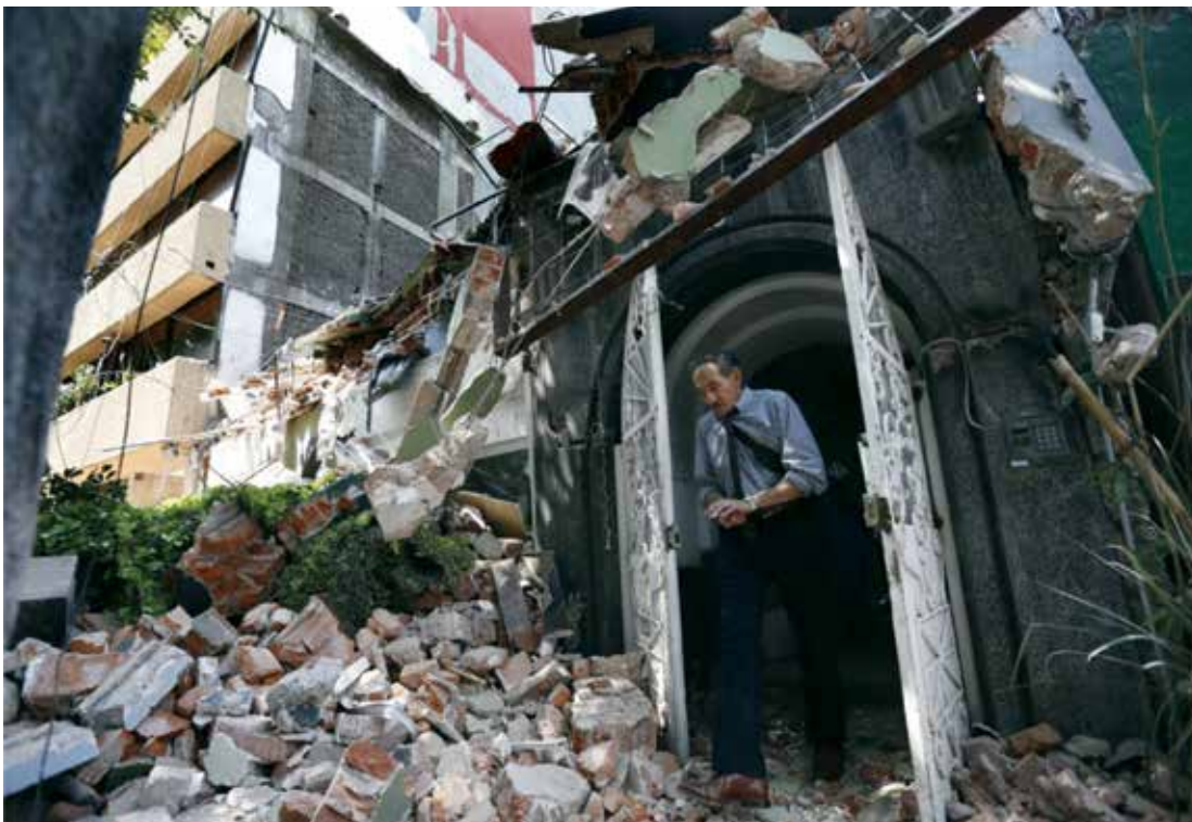
Figura 2. Edificio de la colonia Condesa, Ciudad de México, dañado por el sismo de magnitud 7.1. en 2017 (fotografía: El País , Marco Ugarte, AP).
